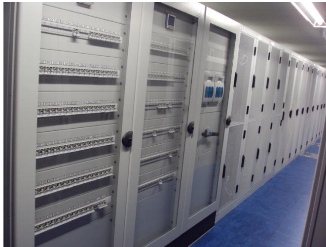
Distribuição de energia em data center com proteção por fusíveis
