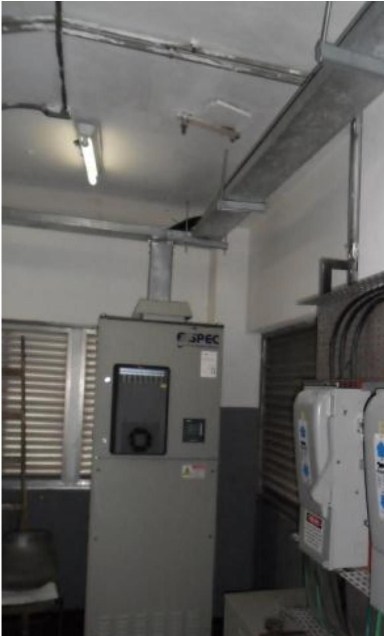
FIGURA 5 – EQUIPAMENTO DE COMPENSAÇÃO REATIVA INSTALADO NA SALA DE MAQUINAS DOS ELEVADORES
