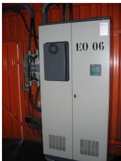
Figura 1 Equipamento de compensação de energia reativa tempo real instalado 430 kvar / 480V
