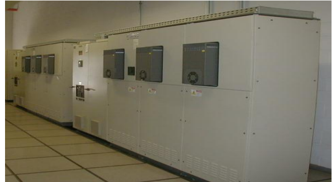
Figura 14 – Compensadores de energia reativa instalado no centro de dados – 2 x 1125 kvar/480V.
